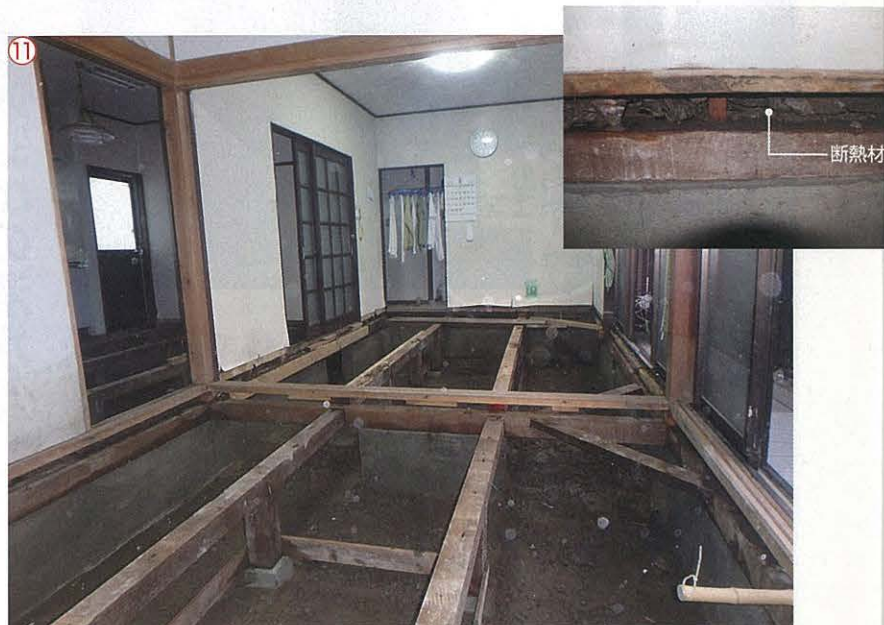
⑩ 若宮戸地区で⑨より少し川に近い場所に建つ、築30年の住宅。床上から約10cmの高さまで浸水したため、壁のラスボードと断熱材のグラスウールが泥水を吸い込み、木部がぬれていた。床材は全て剥がし、布基礎にたまった水と土を乾かしていたが、被災後10日たってもまだかなり湿っていた (写真:下は金井工務店)
