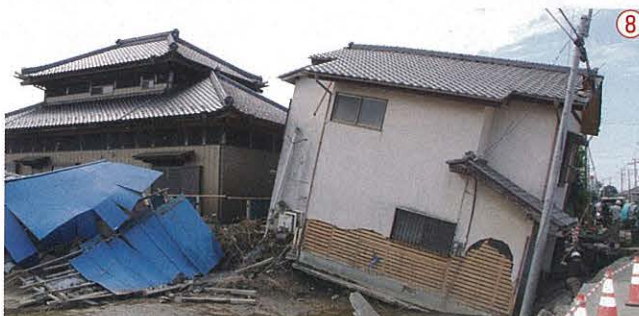
右側の住宅は前面道路側が約1.5m沈下したため、住宅が傾き外壁や躯体が壊れた。建物の正面が沈下したのは、正面にぶつかった水が裏下に回り乗らぬ地盤を削ったためだと推測できる。洗掘のよくあるパターンだという
