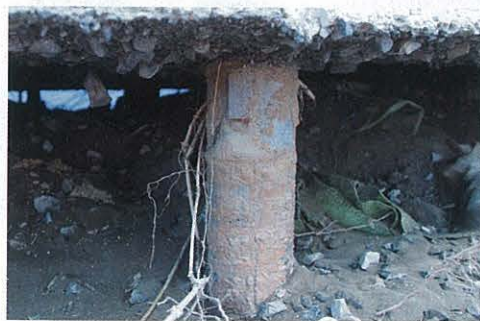
流れてきた木造住宅をせき止めた、旭化成ホームズの軽量鉄骨造住宅。長期荷重を想定した直径114mm、長さ約10mの銅管杭19本で地盤を補強している。杭頭が底盤部に多少めり込んでいた。基礎は布基礎。地盤から高さ約65cmの場所に汚れの痕が見つかっているため、それほど浸水は深くなかったと思われる
